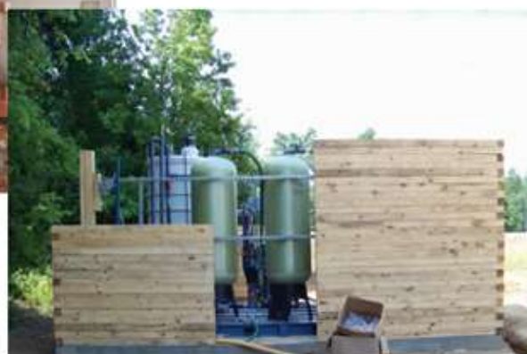
Pequeno sistema de tratamento de águas subterrâneas com dois tanques de GAC
