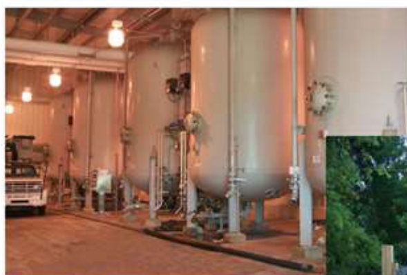
Grande sistema de tratamento de águas subterrâneas com cinco tanques de GAC
