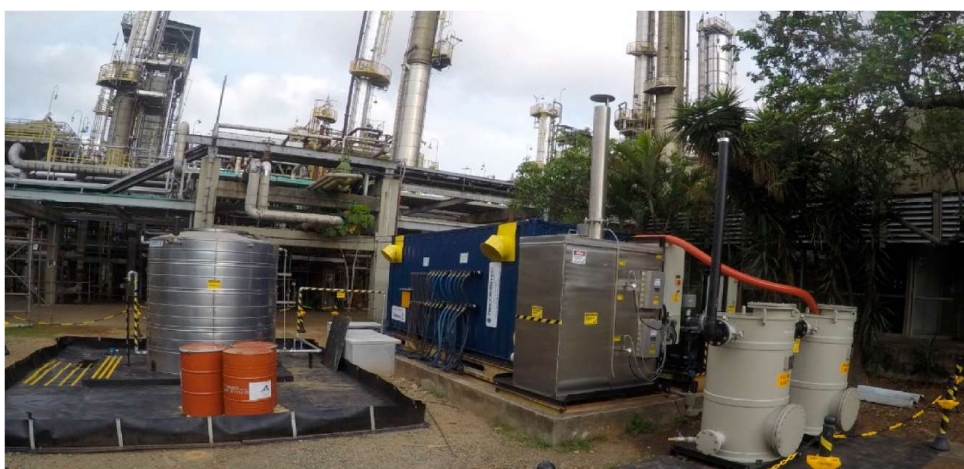
Figura 13: Foto de um sistema de tratamento por oxidação térmica
